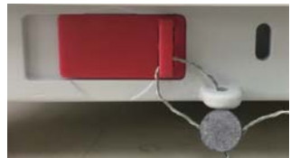
Bloqueado con cable de sellado
