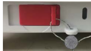
Bloccato con Sigillo di Cavo
